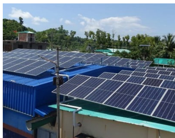
Paneles solares instalados detrás del establecimiento de salud de la OIM en el asentamiento de refugiados rohinyás en Balukhali. © OIM 2018/Olivia Headon
